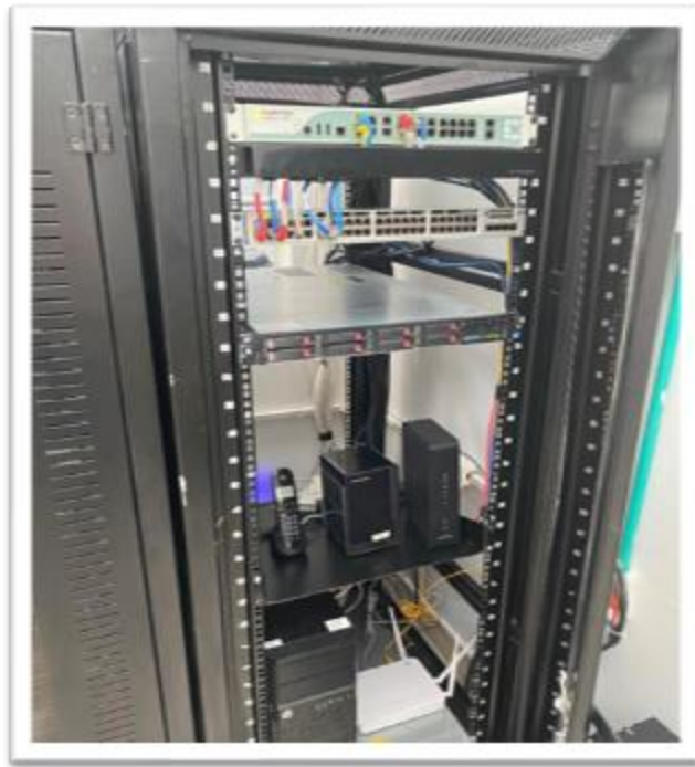
Figura 3. Equipos de ruteo de la empresa CYMA Ingeniería Ltda.
