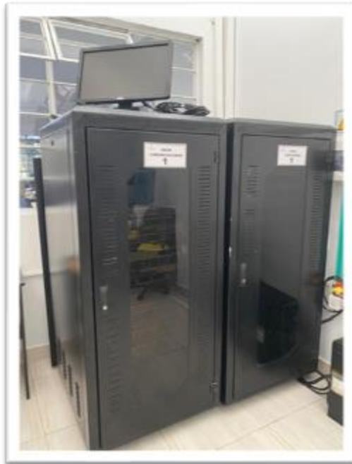
Figura 2. Cuarto de equipos de la empresa CYMA Ingeniería Ltda
