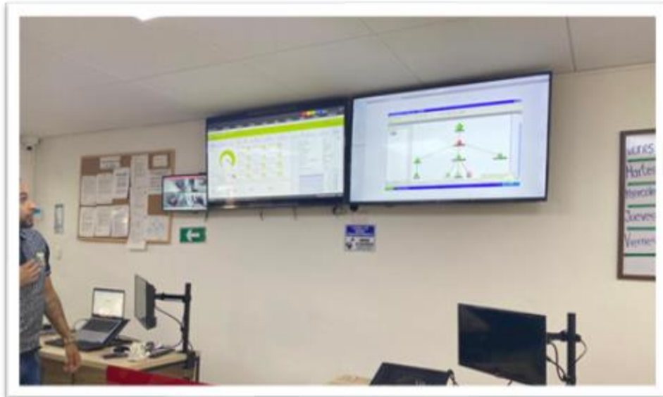
Figura 4. Configuración de la topología de red en la empresa CYMA Ingeniería Ltda.
