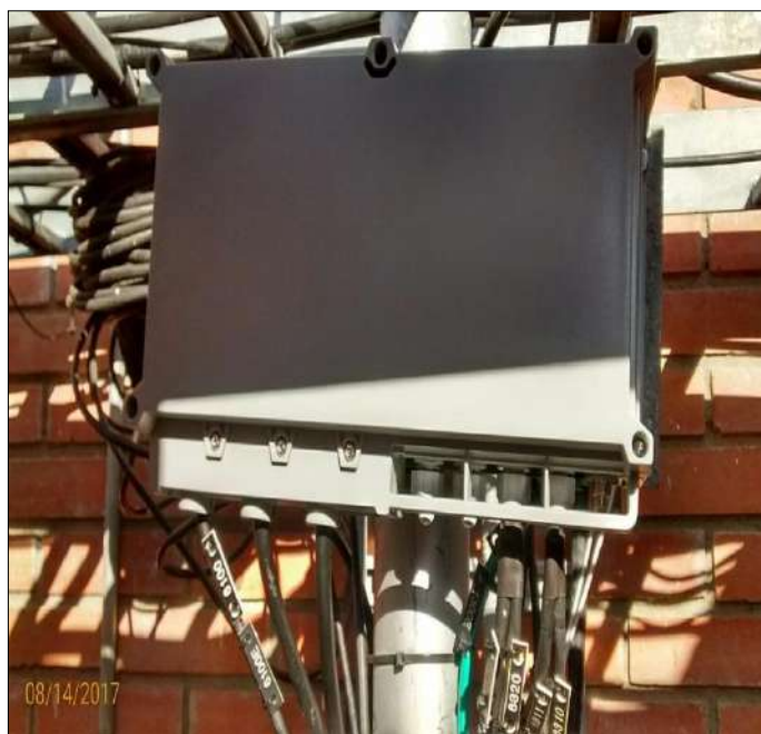
Figura 19: caja de alarmas, imagen tomada y modificada desde [4].
