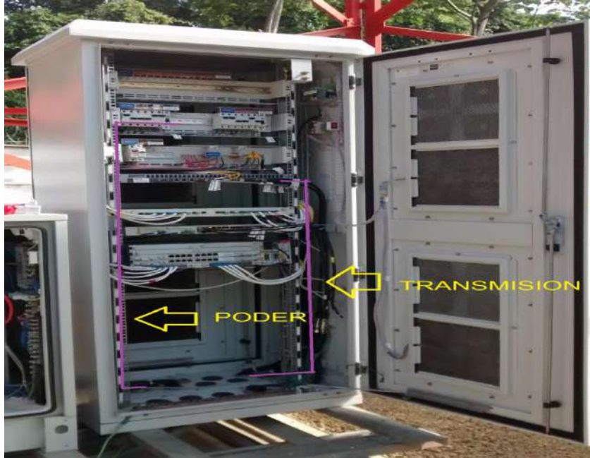
Figura 25: montaje en equipo de transmisión [2].
